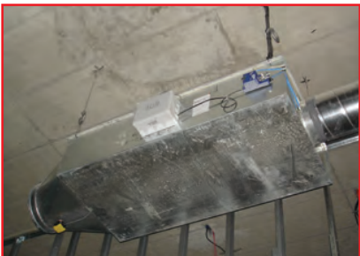
Fan coil units
